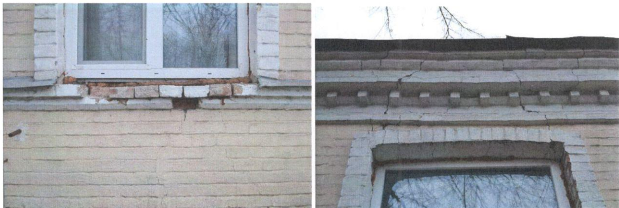
Рис. 2.4 – Руйнування віконних імпортів та тріщини у несучих цегляних стінах
