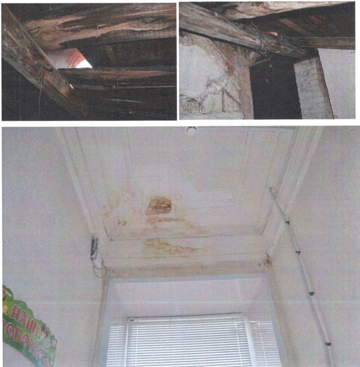
Рис. 2.9 – Замокання конструкцій покрівлі та стелі приміщень
