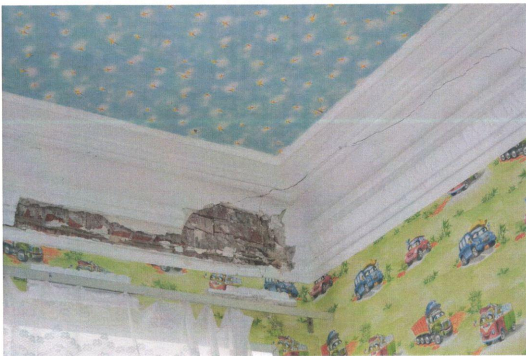
Рис. 2.7 – Обвалення елементів штукатурного шару
