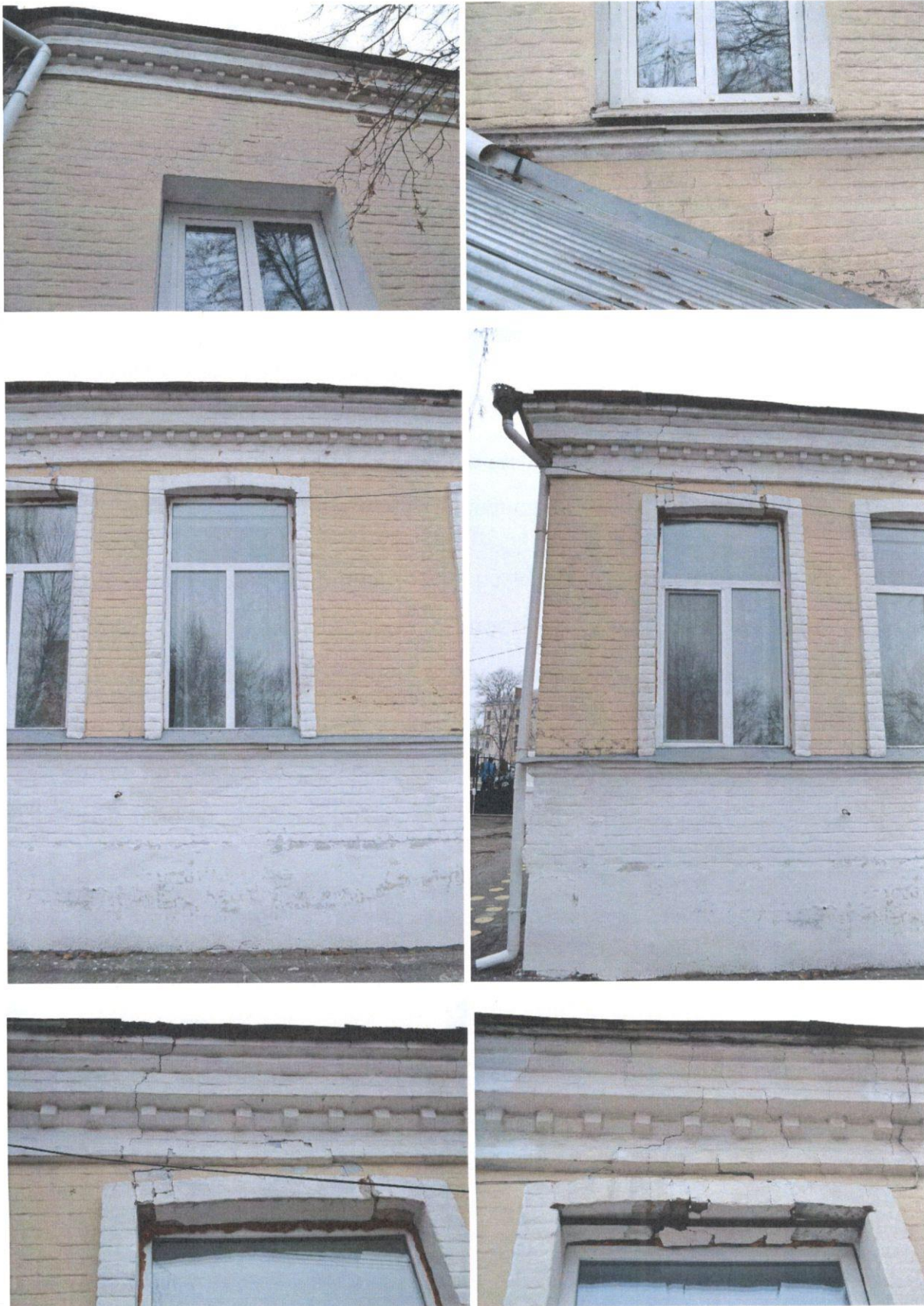
Рис. 2.5 – Руйнування віконних імпортів та тріщини у несучих цегляних стінах
