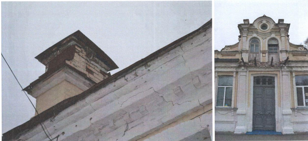
Рис. 2.6 – Морозобійне руйнування та вивітрювання розчину швів цегляної кладки. Руйнування балкону
